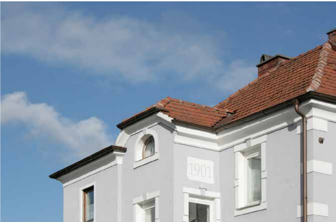
Walmdach samt Walmgaube werden in Kupferrohren entwässert, Salzburger Straße 33
