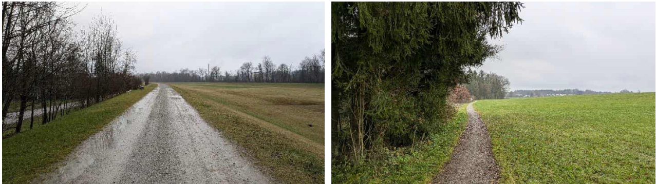
Abbildung 33: Oberflächenbeschaffenheit für Basisnetz ausreichend (links), Oberflächenbeschaffenheit für Hauptnetz unzureichend (rechts)
